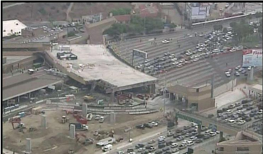
Figura 10: Colapso del techo del puerto de entrada San Ysidro
